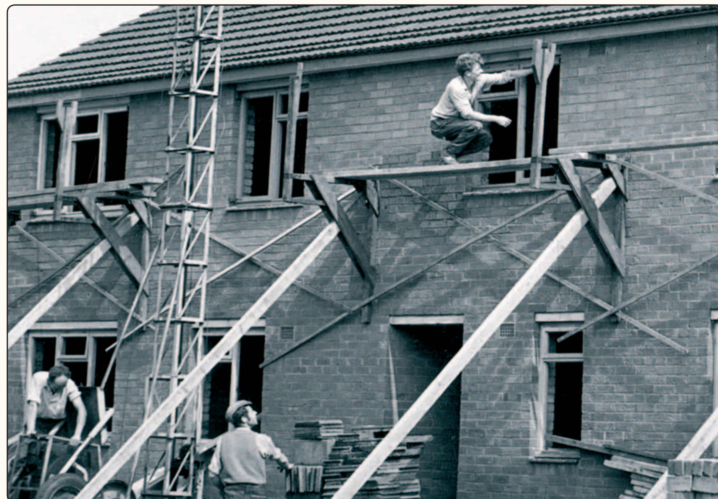
New council housing under construction on Lorne Street. Tai cyngor newydd yn cael eu hadeiladu ar Lorne Street.
